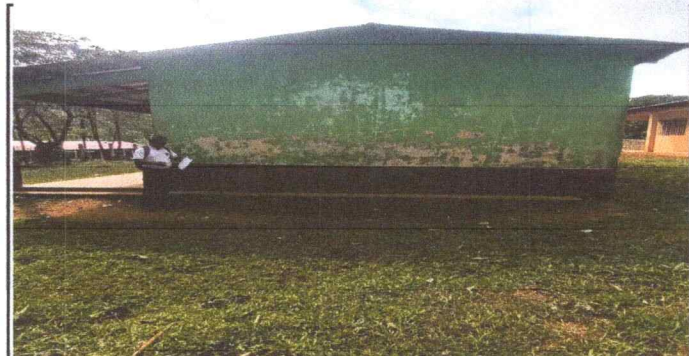
Foto 4: La pared se observa en condiciones deteriorada.
